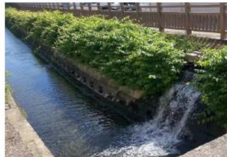
Punto de reabastecimiento del canal de descarga de
